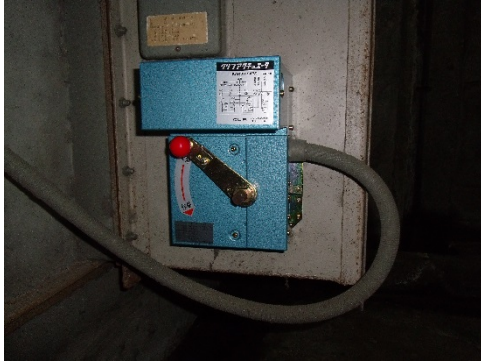
例 1 : 塩害地域・OA系ダクト
